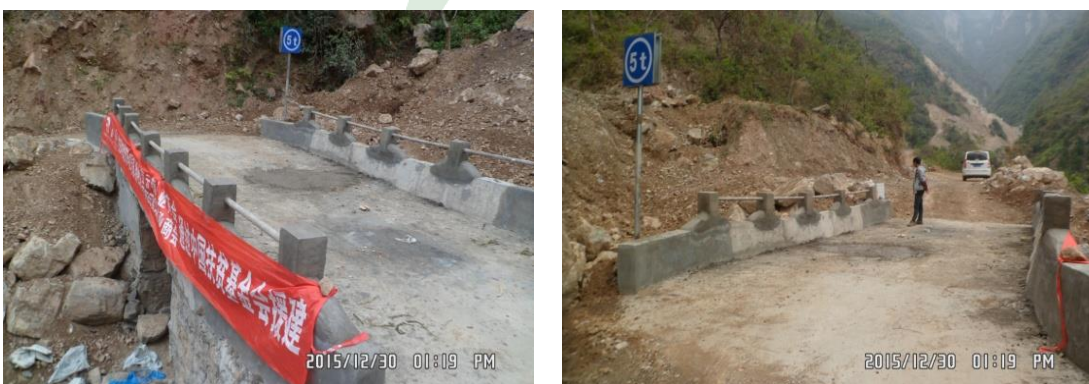
图三十五：梭山镇甘田村沟头社爱心桥主体施工基本完成
